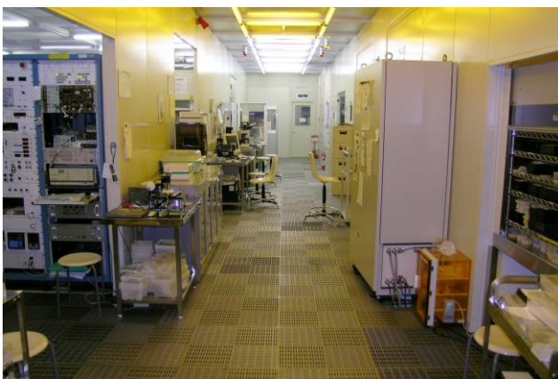
Super clean room in west building. 西棟スーパークリーンルーム
